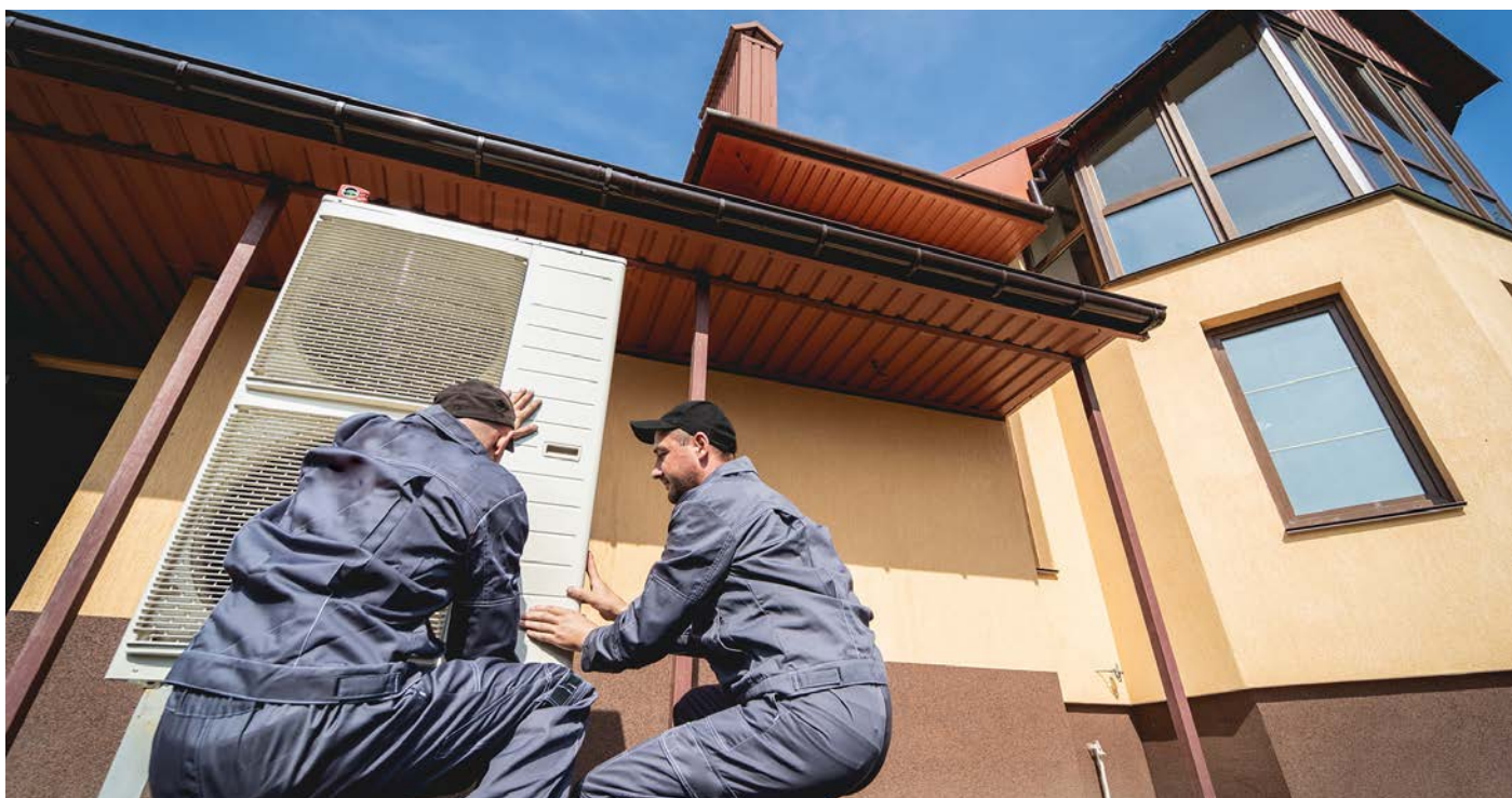
Symbolfoto Wärmepumpe. AdobeStock_477978525
